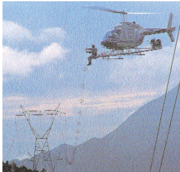
Para el mantenimiento de las grandes redes de transporte se utilizan helicópteros que mejoran la eficacia.
